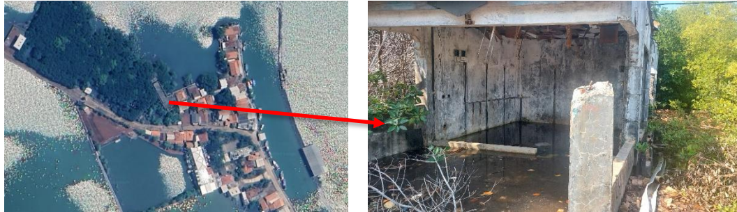
Gambar 11. Rumah Terbengkalai yang Terendam Air Laut di Desa Mayangan (Lokasi A)
