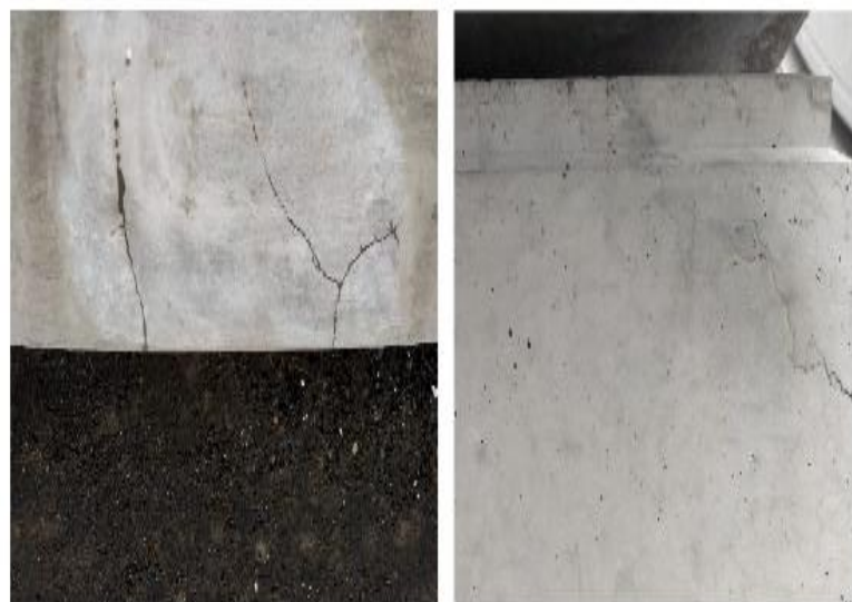
Gambar 2. Kondisi Retak Sumber : (Dokumen Pribadi, 2023)
