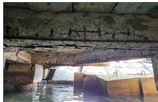
b. Kerusakan Pada Balok dan Pelat Lantai
